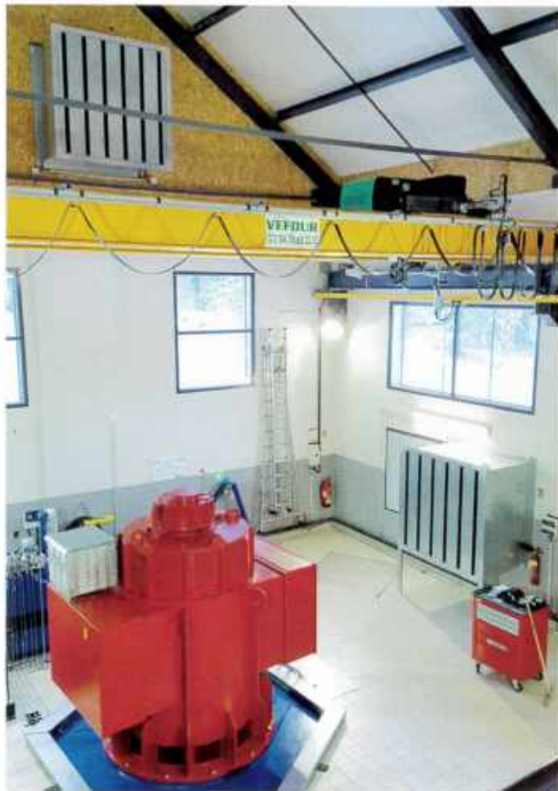
▲ La centrale de Laval (Isère) est équipée de silencieux sur l'entrée et la sortie d'air. Photo : Spectra
